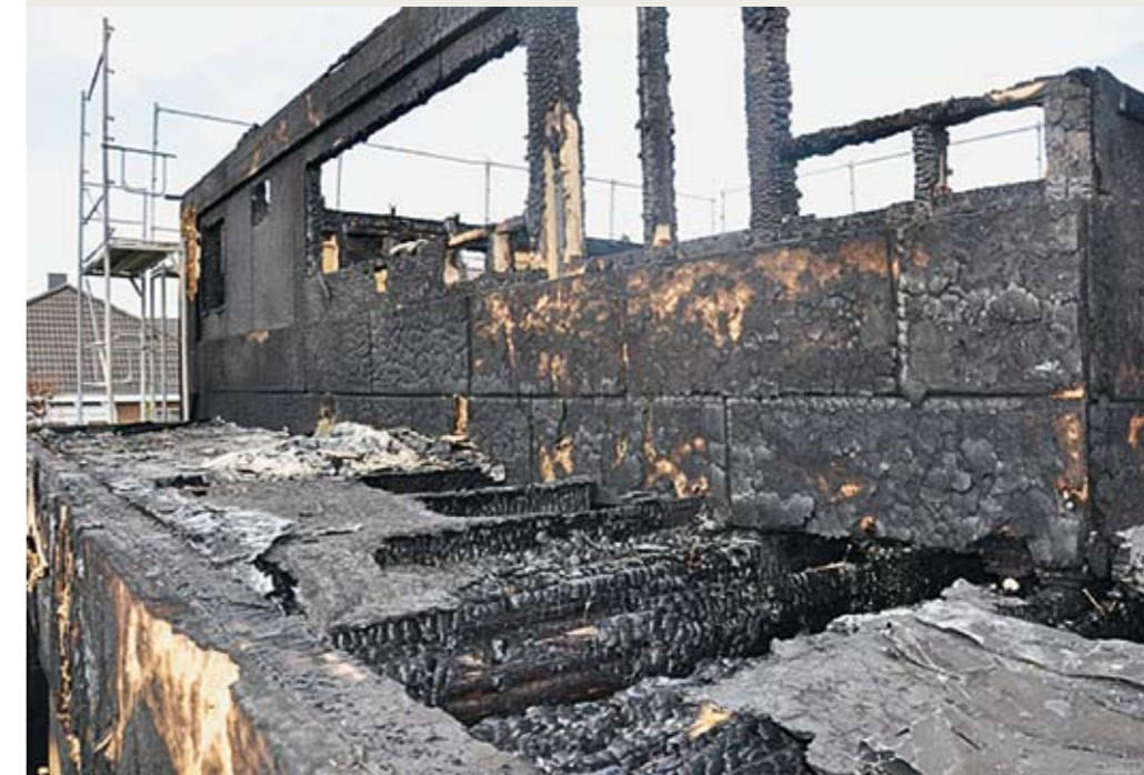
Die Holzständerbauweise und eine im Bau befindliche Holzfaser-Dämmfassade boten den Flammen ausreichend Nahrung. Nachbarn hörten in der Nacht einen „lauten Knall“.
