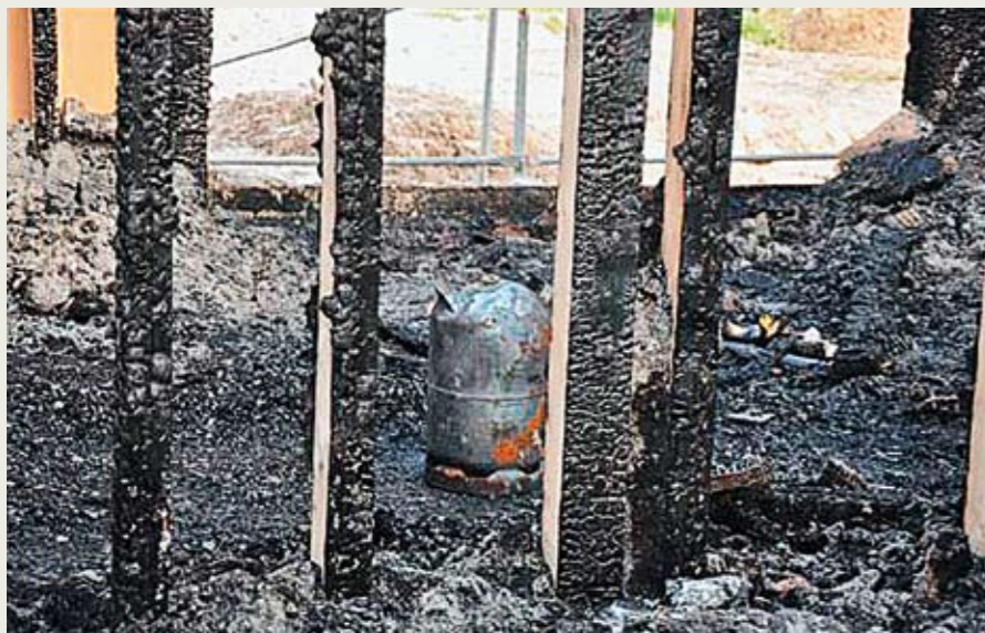
Die Ursache des „lauten Knalls“ wurde nach den Löscharbeiten lokalisiert. Im Gebäude befand sich eine 11-kg-Propan-Gasflasche, welche die Handwerker im Gebäude deponiert hatten.
