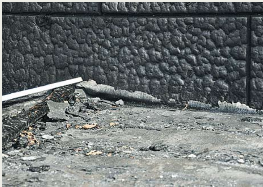
Die Situation des Übergangs vom Dach zur aufgehenden Fassade. Deutlich erkennbar die verkohlten Reste der glasliesverstärkten bituminösen Dachbahn.
