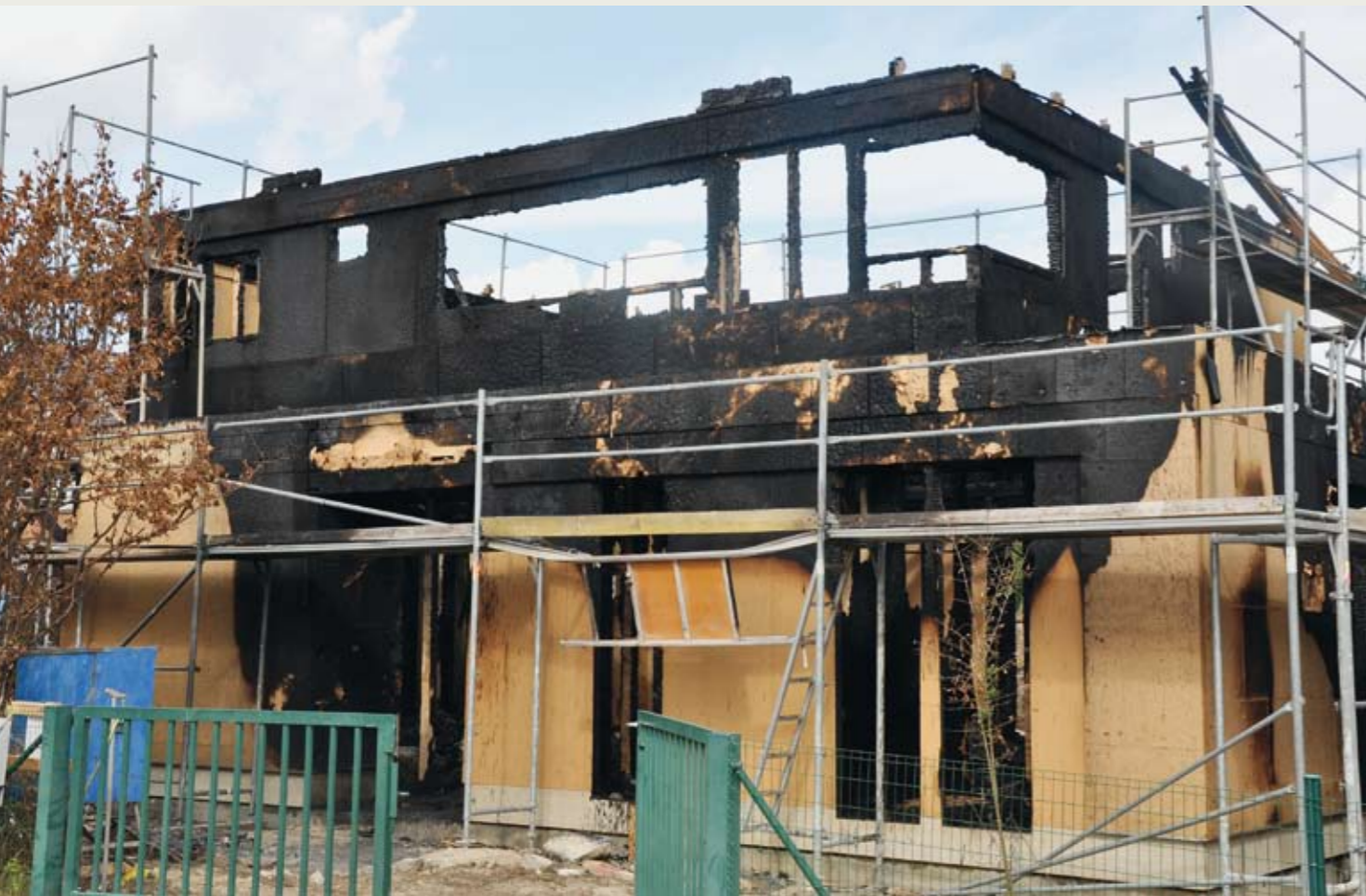
Das in der Bauphase befindliche Wohnhaus in „Holzbauweise“ fiel komplett den Flammen zum Opfer. Ursache war ein nicht erkannter Schwelbrand, welcher sich, genährt durch Sauerstoffzufuhr, zu einem Großfeuer entwickelte.
